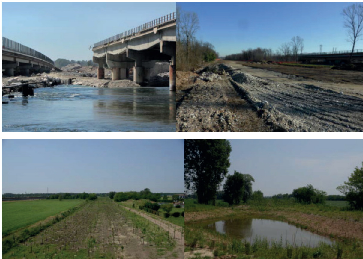
Figura 2 – Demolizione del sedime autostradale (foto in alto) e interventi di recupero forestale e creazione zone umide (foto in basso).
